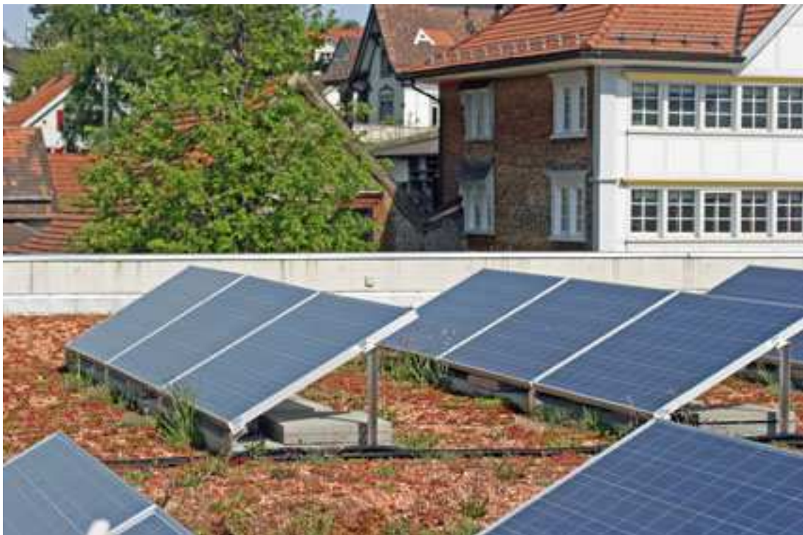
Ein Blick auf einen Teil der Solarpanels der Photovoltaik-Anlage auf dem Dach der Raiffeisenbank Heiden.
